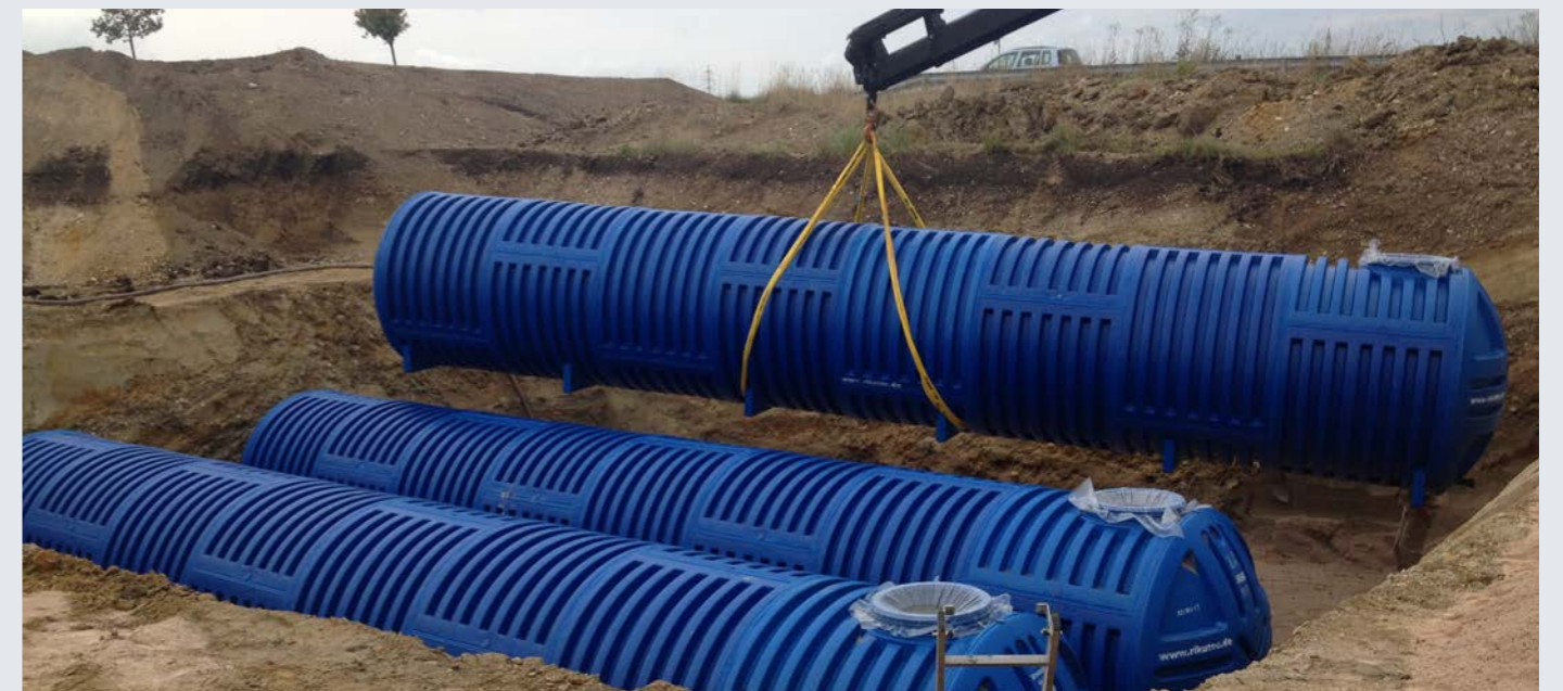
(Einbau Aqua'Terne 204 – Batterie „Löschwassertank“)
